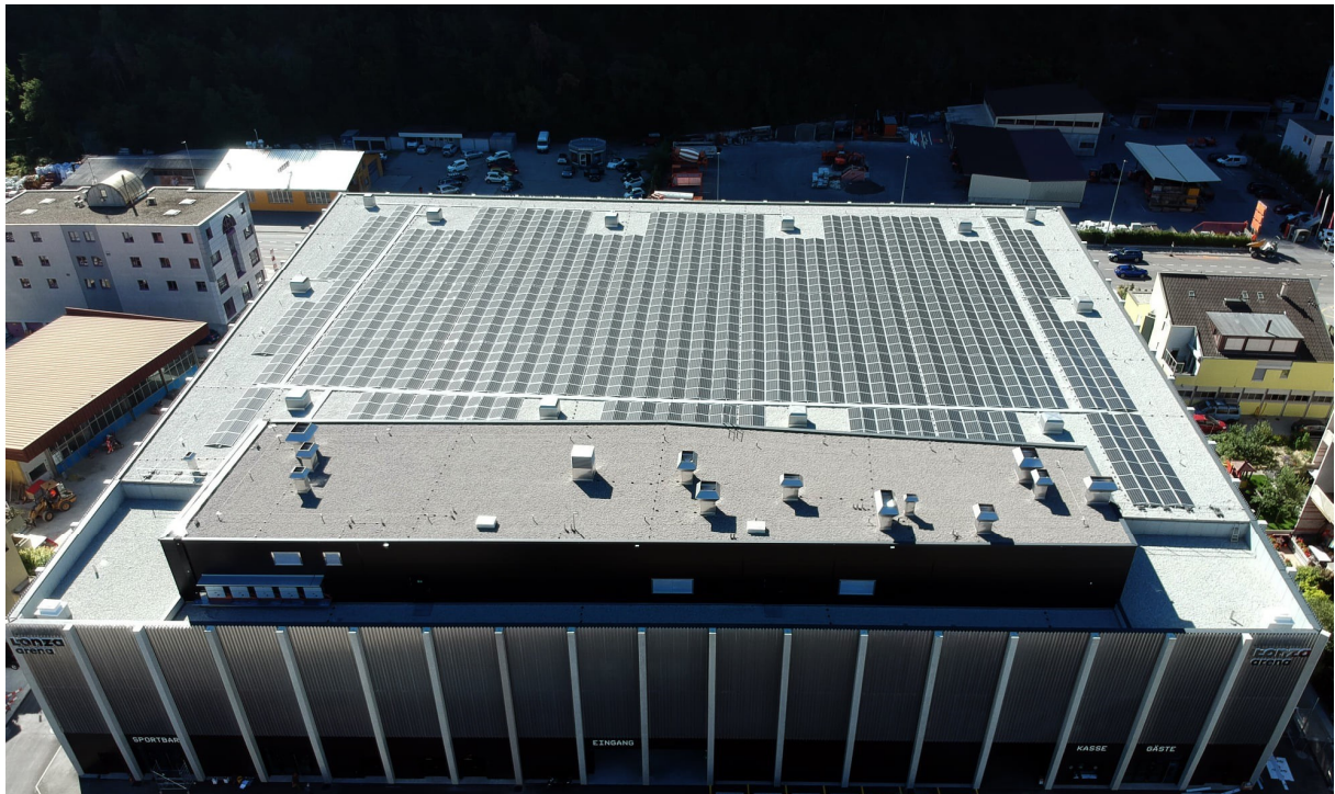
Die Photovoltaik-Anlage auf dem Dach der Lonza Arena in Visp.
